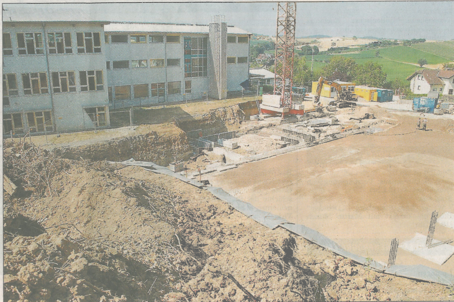
Auf dem Platz der alten Halle direkt an der Schule: Die Baustelle für die neue Sporthalle, die komplett von der Dietmar-Hopp-Stiftung bezahlt wird. Auch dem neuen Projekt „Inklusion durch Sport“ des Vereins „Anpfiff ins Leben“ steht sie zur Verfügung. Foto: Weis
